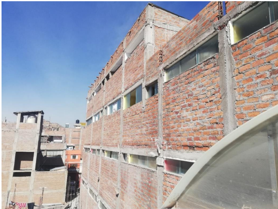
Fotografía N° 27: Problemas de columna corta encontradas en la mayoría de viviendas
