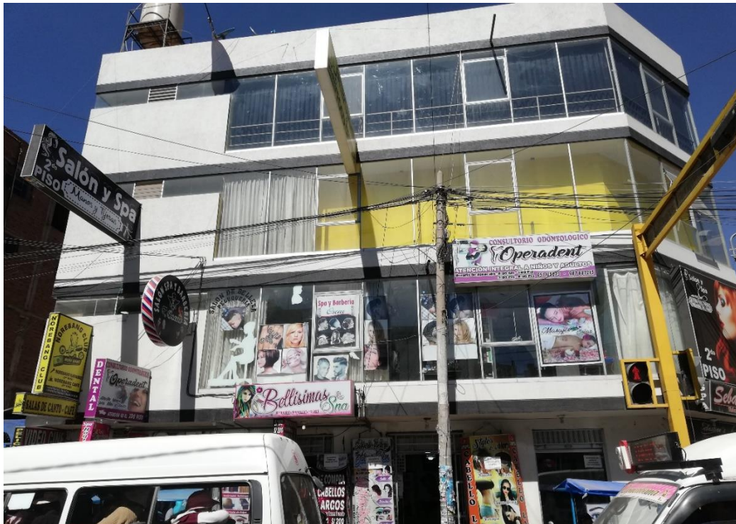
Fotografía N° 18: Irregularidades estructurales encontradas.
